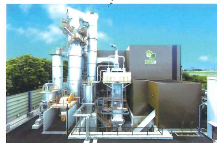
焼却プラント
