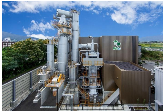
焼却工場(31.2tストーカー炉) (2021年9月稼働開始)
